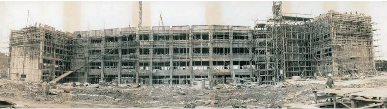
グラウンドより眺めた旧本館の新築工事で、ほぼ4階までの外観は出来上がり、給水槽のある塔屋部分の工事前の建物。 (昭和39年10月) (現1号館)
