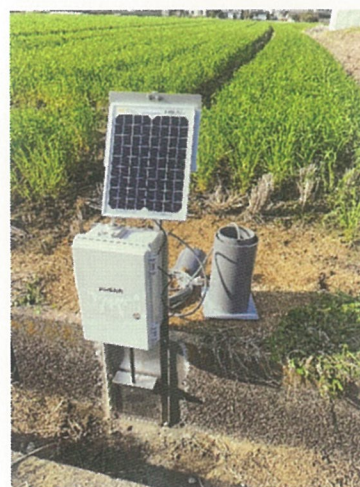
写真-1 IoT 水門の設置状況
