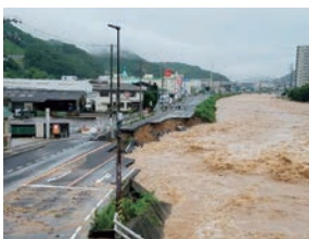
▲国道2号線・崩落(瀬野川)
