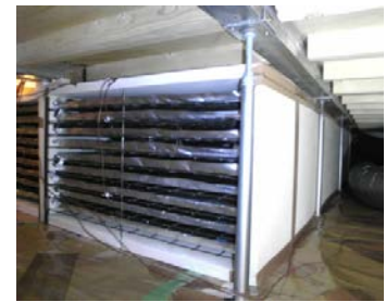
図2. 床下に設置した潜熱蓄熱体
